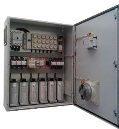
Bancos de capacitores
